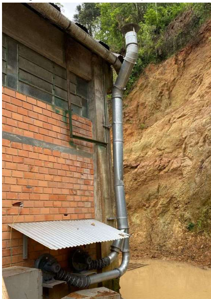
Figura 05 – Parte externa da tubulação da exaustão
