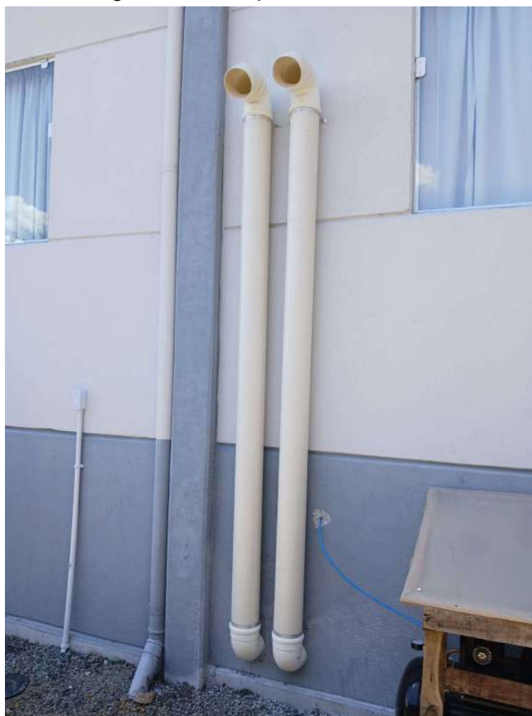
Figura 03 – Tubulação externa da exaustão
