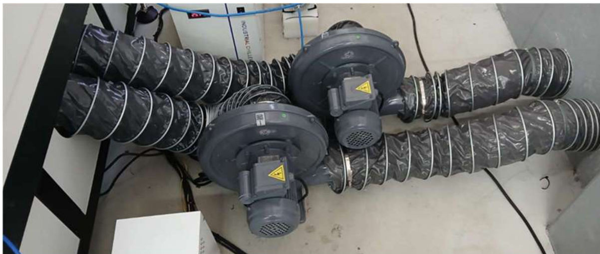
Figura 02 – Sistema de exaustão anexo a máquina.
